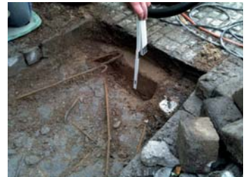
1.3 Korrosionserscheinungen in Bewehrungen
